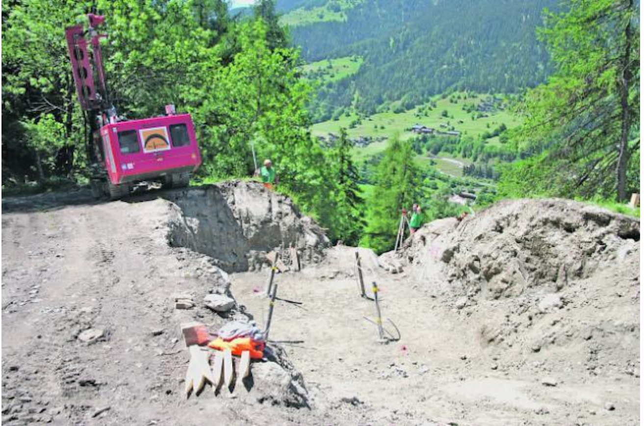
Aushubarbeiten. In dieser Vertiefung wird ein Fuss eines Mastens verankert. Foto: wb
